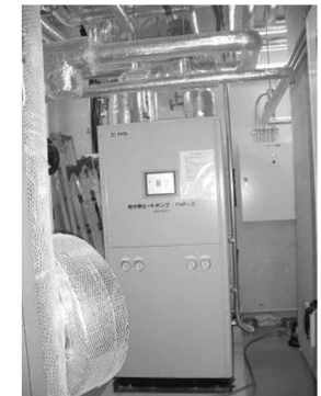
地中熱ヒートポンプ25馬力
