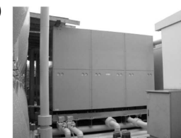
地下水利用ヒートポンプ 90HP(合計260HP)
