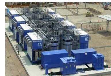
レドックスフロー電池
