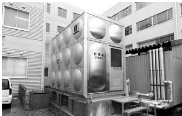
図 17 貯湯槽 (16 m³ 屋外設置)
