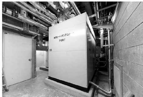
図 16 地下水熱利用ヒートポンプ （ゼネラルヒートポンプ工業㈱製、 型式：ZQH-75W25d-RK-A、75 馬力相当）
