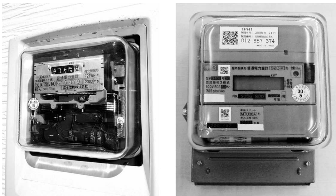
図24 機械式の電力メーター⑤と、関西電力が普及を進める「スマートメーター」 出展：左は宇野澤撮影（2013年2月）、右は関西電力提供
