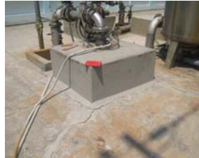
▲地盤沈下による深井戸の抜け上がり
